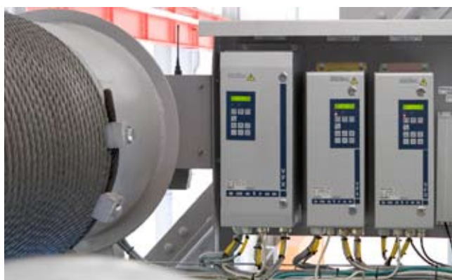
Tack vare IP54-kapslingen kunde frekvensomriktarna installeras på kranbalk och tralla, vilket sänkte installationskostnaden.
