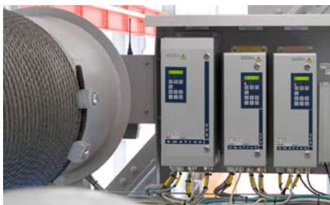
Корпус класса защиты IP54 позволил установить преобразователи частоты на эстакадах кранов и лебедке. Это позволило снизить расходы на установку.
