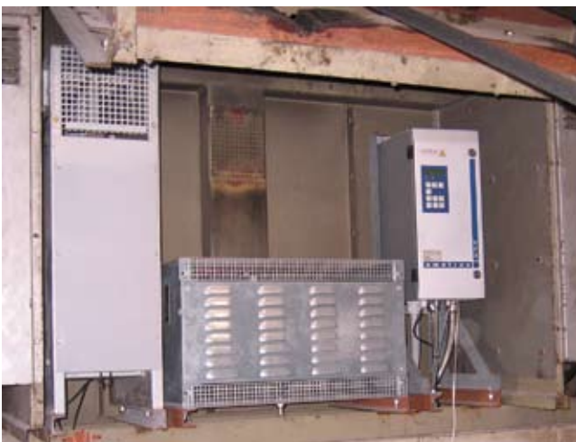
De retrofit bestond uit de installatie van een nieuw elektronisch besturingssysteem, gebaseerd op de Emotron VFX frequentieregelaar, en uit de vervanging van acht aandrijfmotoren.
