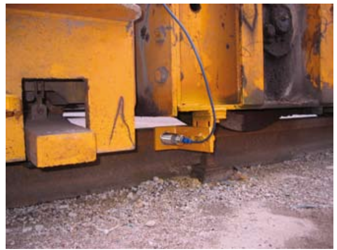
Contact tussen de wielflenzen en de rails wordt voorkomen. De nauwkeurigheid van de signalen van de vier ultrasone sensoren is van vitaal belang voor de werking van de kraan.
