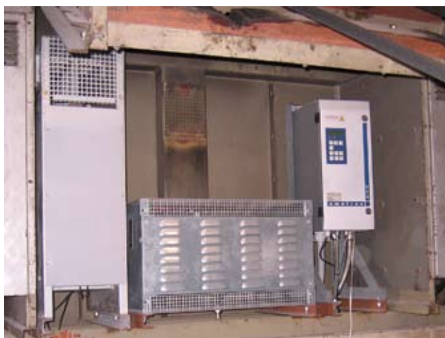
Uppgraderingen innebar att ett nytt elektroniskt styrsystem installerades baserat på Emotron VFX frekvensomriktare, samt att de åtta drivmotorerna byttes ut.
