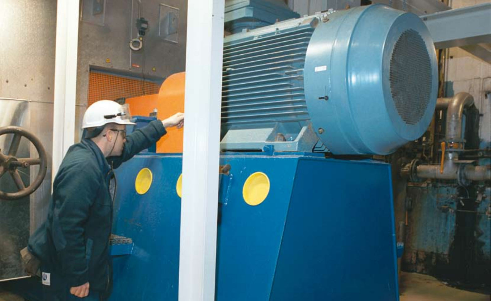
Martin Ljungqvist, voorman bij de elektrische afdeling van Hydro Polymers, controleert één van de rookgasventilatoren van de stoomcentrale, die wordt geregeld door Emotron frequentieregelaars.
