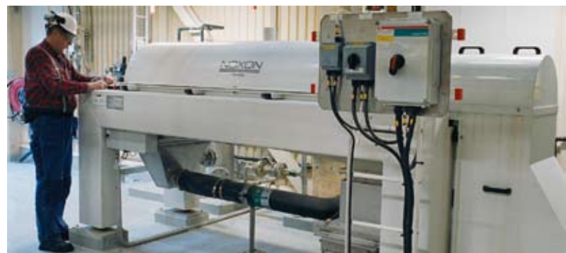
El operario Gary Karvinen, trabajando en una centrifugadora de lodos en la planta de tratamiento de aguas residuales. La centrifugadora se controla con un variador de velocidad Emotron VFX, al igual que los soplantes que oxigenan las aguas residuales.
