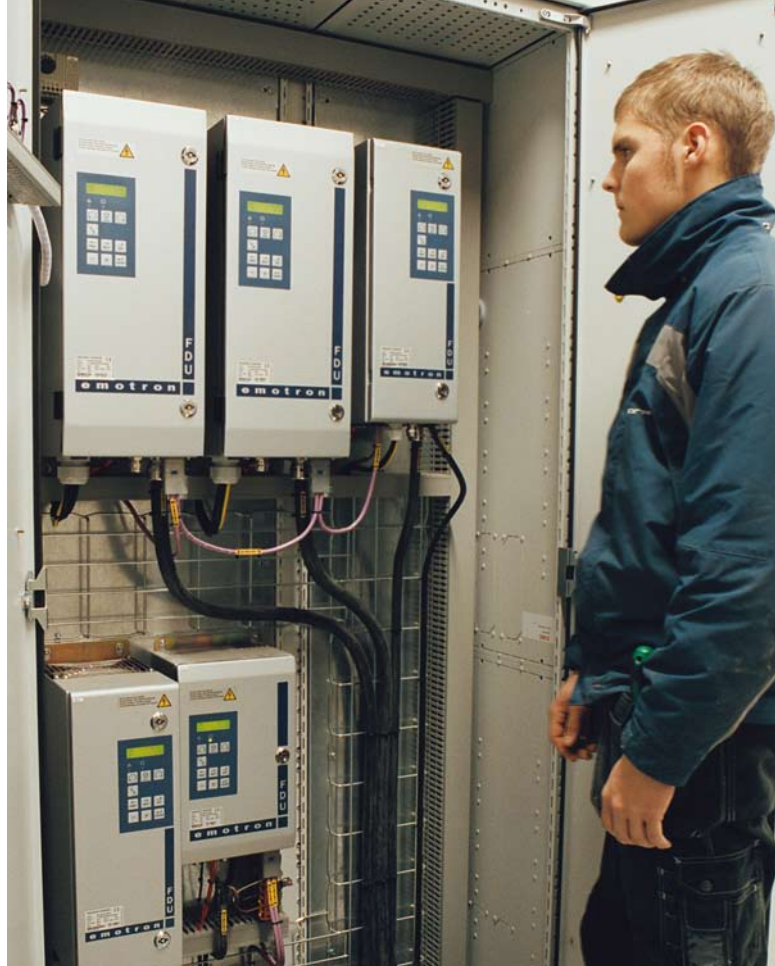
Anläggningens elva Emotron FDU frekvensomriktare är monterade i ett elektronikum. Att ha dem samlade underlättar styrning och övervakning, anser driftsteknikern Oskar Österling.
