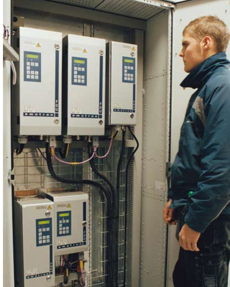
Die elf Emotron FDU Frequenzumrichter der Anlage sind in einem Elektronikraum installiert. Da sie alle an einem Ort stehen, werden laut Betriebstechniker Oskar Österling Steuerung und Überwachung erleichtert.
