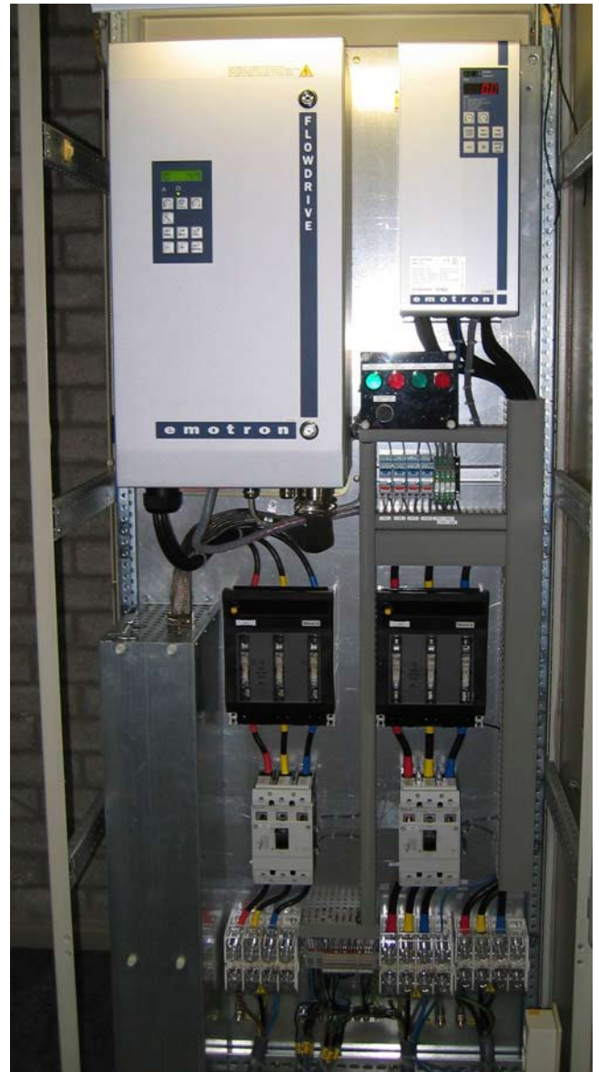
I den nya installationen startas pumparna i stället med en Emotron FDU frekvensomriktare och en Emotron MSF mjukstartare, och styrs av en pumpstyrenhet, som är helt integrerad i frekvensomriktaren.
