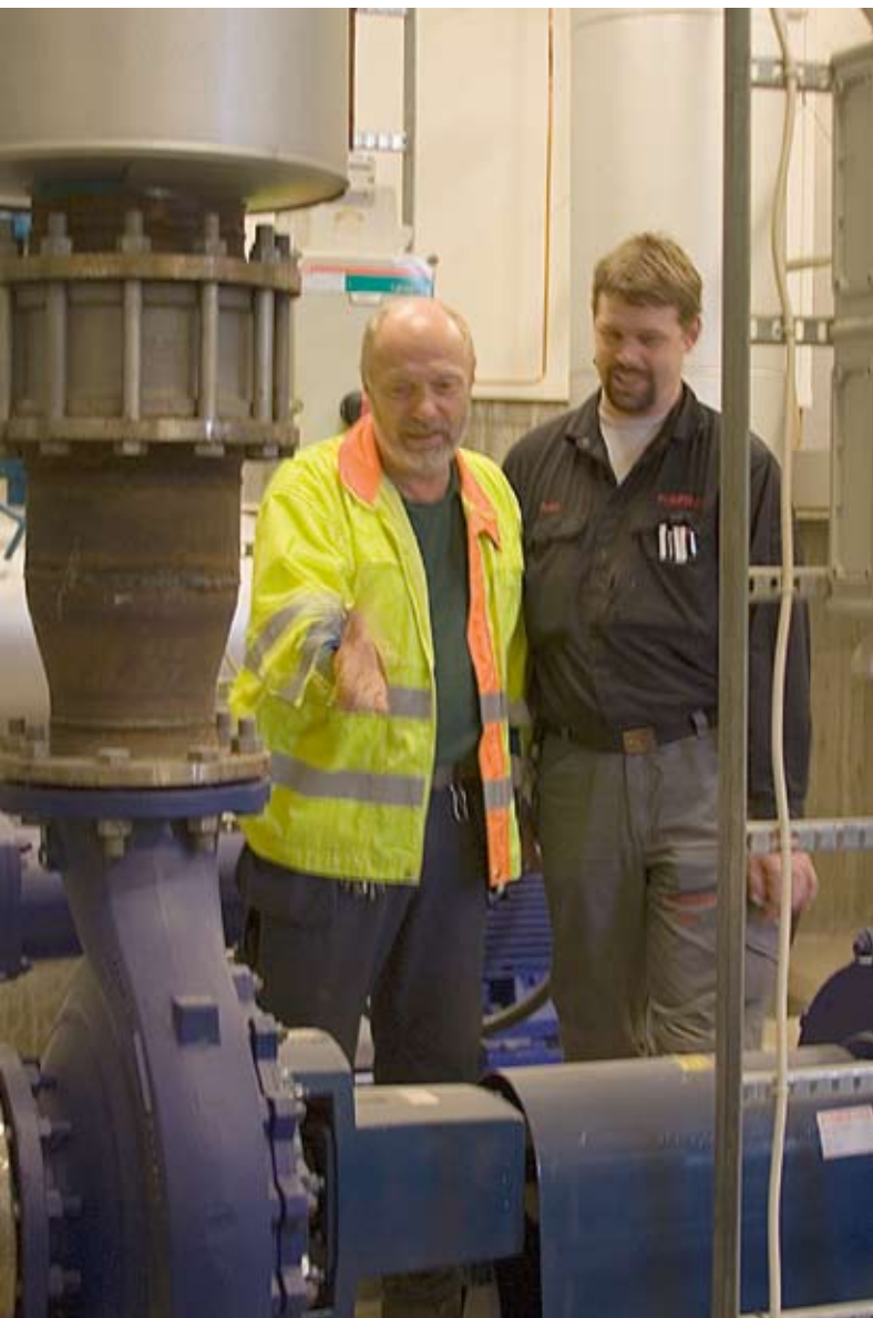
Drei Pumpen erzeugen den benötigten Druck in den Rohren des Fernheizungssystems der Kommune. Peter Johannisson (r.) und Franc Rostedt (l.) sind mit den erweiterten Funktionen der neuen Emotron FDU 2.0 sehr zufrieden. „Der integrierte Belastungssensor schützt vor Trockenlauf, und wir können mit nur einem Frequenzumrichter mehrere Pumpen steuern“, erklärt Peter Johannisson.
