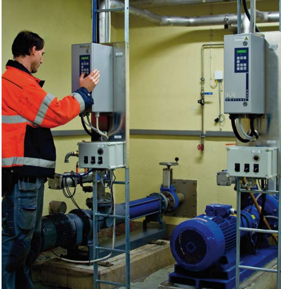
Falkenberg kommun använder Emotrons produkter som standard i sina elmotordrifter. – Framför allt uppskattar vi användarvänligheten och att vi får bra support om det uppstår problem, säger driftelektriker Tomas Bjurklint.
