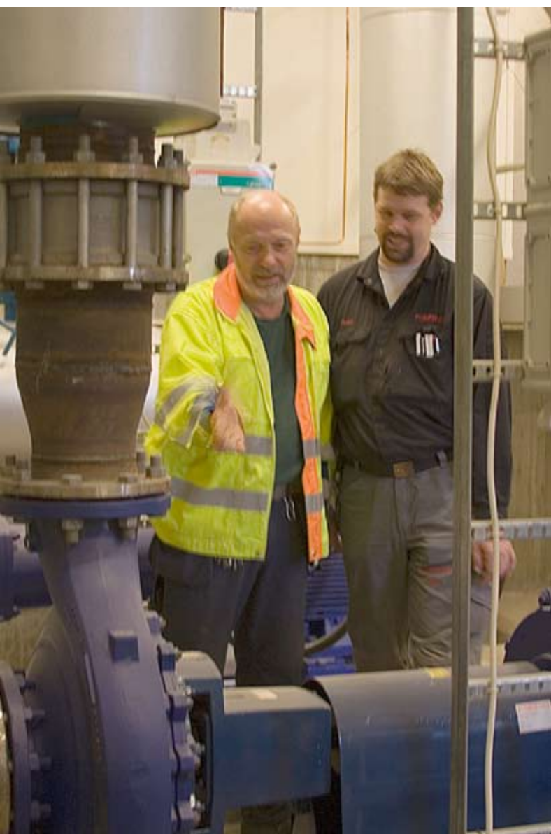
Tres bombas mantienen la presión en las tuberías de la red de calefacción urbana. Peter Johannisson (dcha.) y Franc Rostedt (izq.) están encantados con las funciones ampliadas del nuevo Emotron FDU 2.0. «El limitador de par electrónico integrado impide el funcionamiento en seco y podemos regular varias bombas con un solo variador de velocidad», dice Peter.
